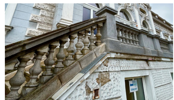
Museum - dringende Sanierung erforderlich
